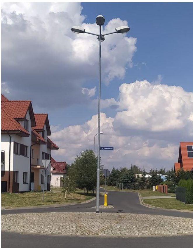
Ryc.13. Istniejąca latarnia. Miejsce podłączenia projektowanej sieci.
