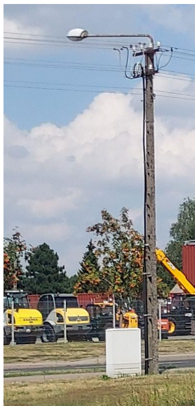
Ryc.13. Istniejąca latarnia. Miejsce podłączenia projektowanej sieci.
